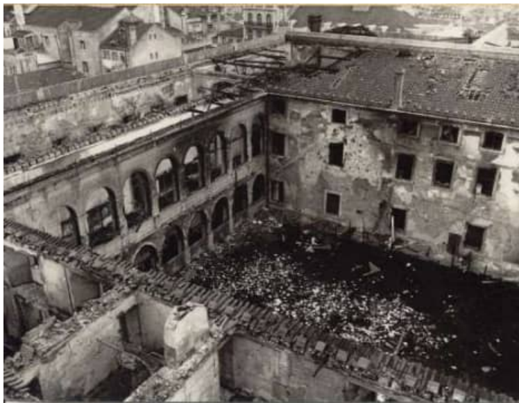
Figura 4. Edifício da FCL na sequência do incêndio de 1978. © ULisboa/MUHNAC.
