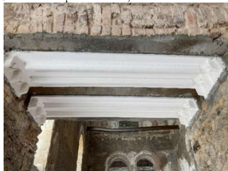
Figura 9 – Contenção de vãos, Museu Nacional da UFRJ
